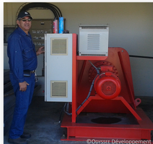
Photo 14 Treuil du slipway 200 tonnes du PANC
